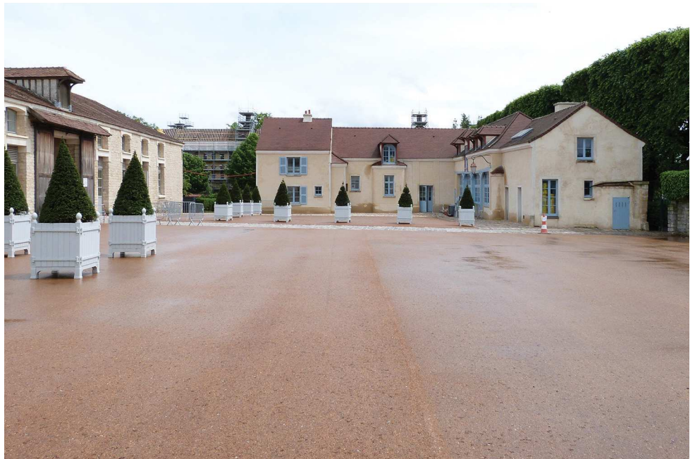
Nouveau revêtement, en enrobé clair, mis en place lors de la réfection de la cour de la ferme. © CD92/O. Bouviala
